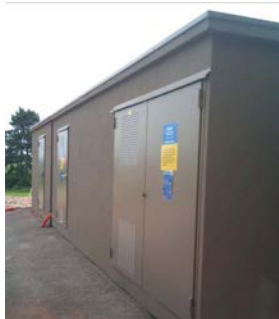
Poste de livraison
